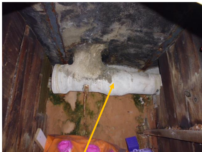
Conduit fibro-ciment suspect Alcôve 3 vers alcôves 2
