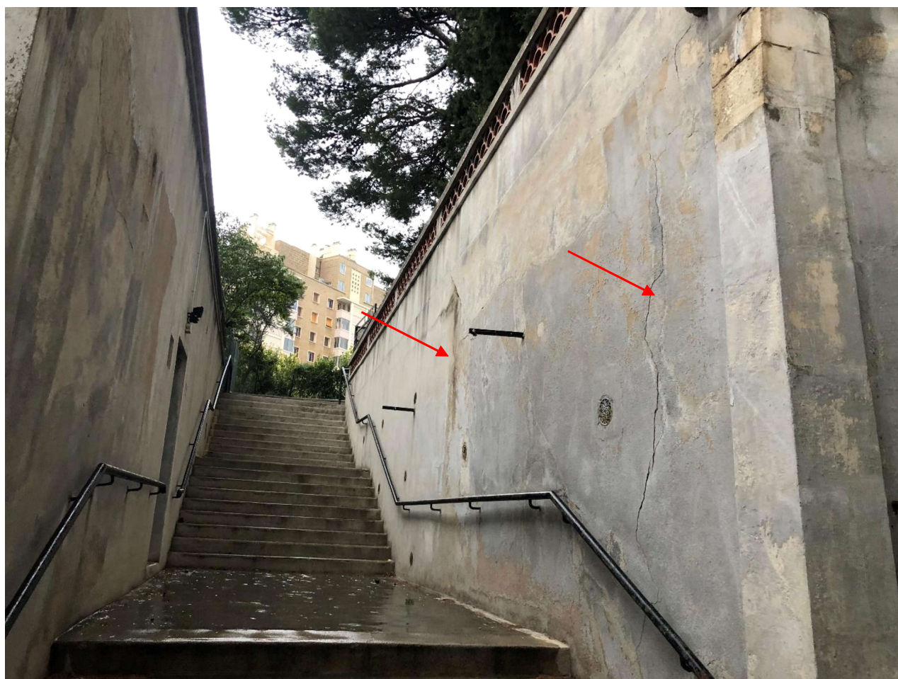
Zones de fissuration sur le mur de l'escalier, en partie basse
