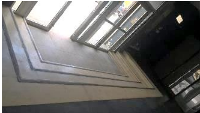
Nécessité de mise en conformité de l'entrée principale
