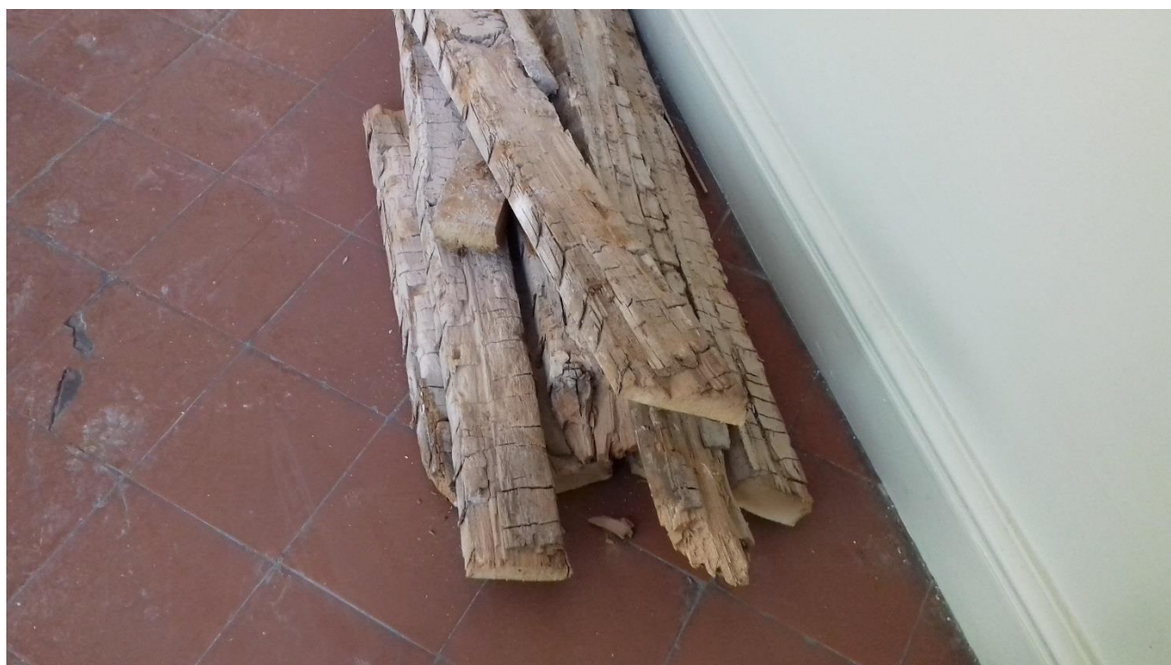
Photo 5 Altération de l'enfutage par de la pourriture cubique
