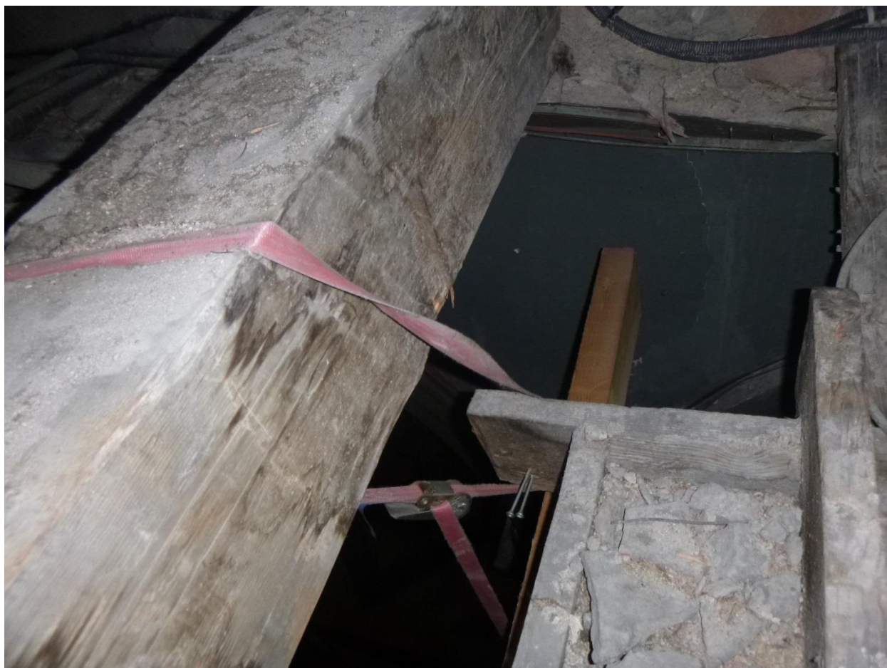
Photo 23 Conséquence du glissement d'assemblage de l'un des deux supports d'extrémités
