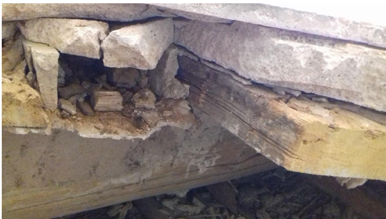
Photo 4 Altération de l'enfutage par de la pourriture cubique
