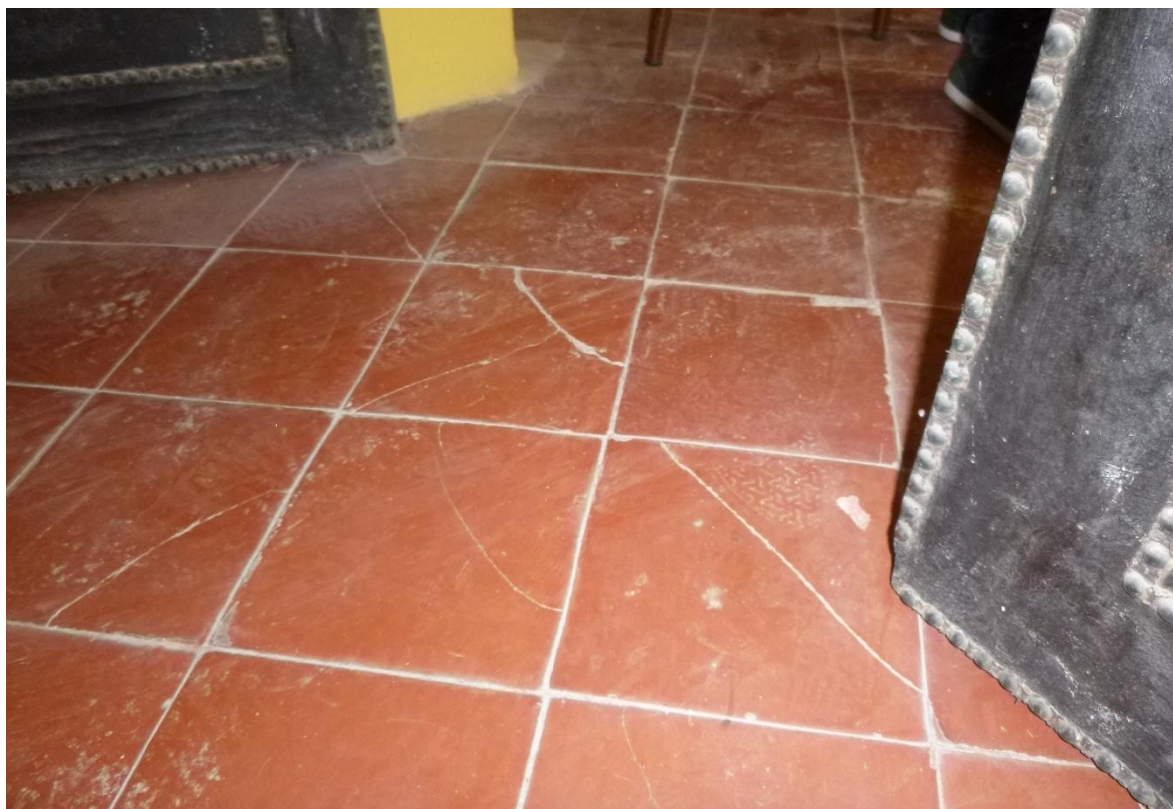
Photo 8 Déformation du plancher (forte flèche avec fissuration du revêtement de tomette)
