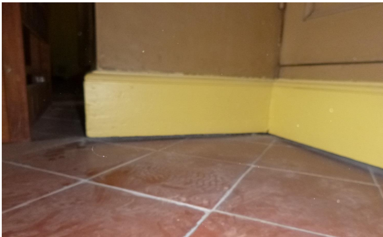
Photo 11 Déformation du plancher (forte flèche avec formation de jeux sous les plinthes)
