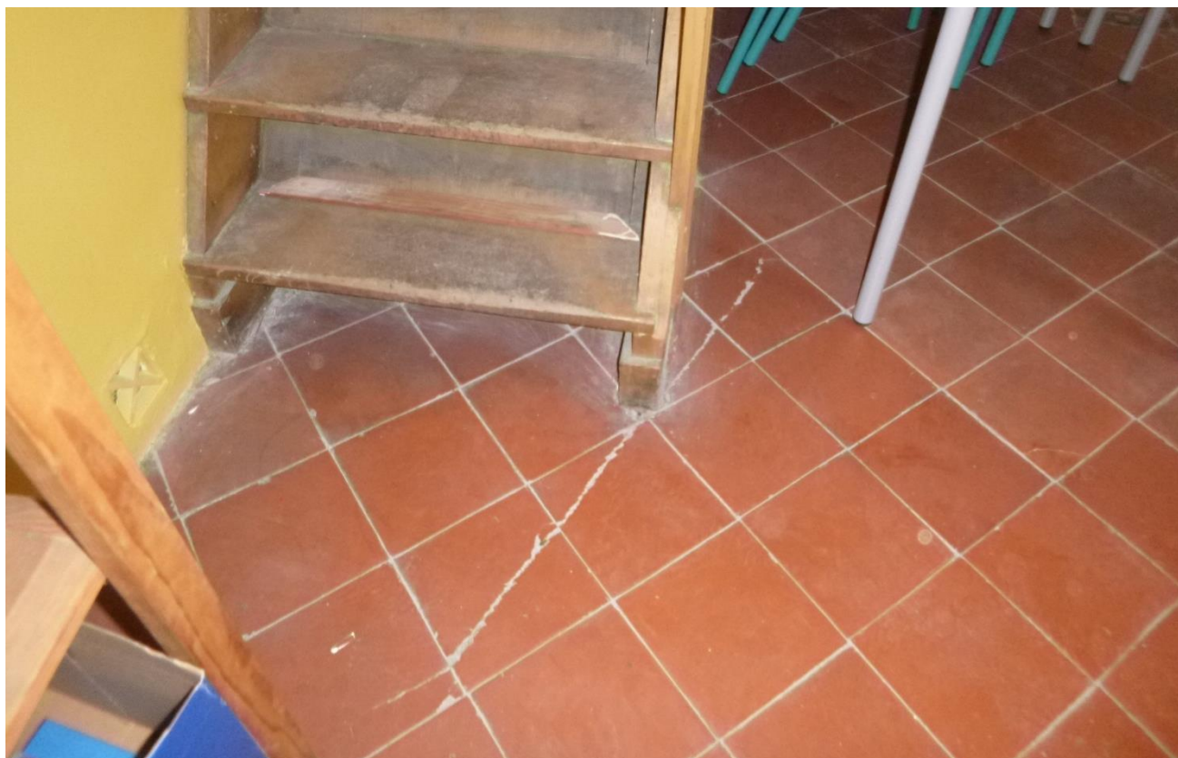
Photo 9 Déformation du plancher (forte flèche avec fissuration du revêtement de tomette)
